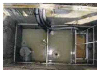
ポンプ 両方作動
